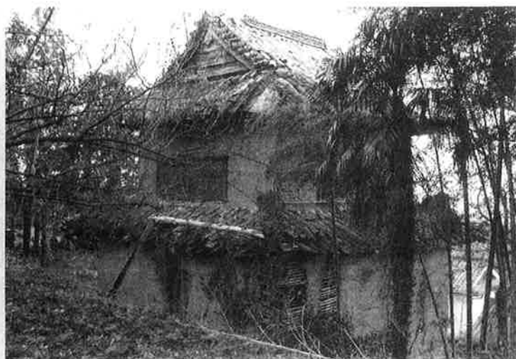
鬼門櫓の惨状（北西より）。壁土は剥がれ、屋根瓦の一部は崩落している。（平成15年2月撮影）
