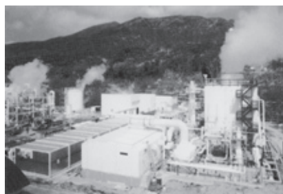
八丈島地熱発電所（東京電力）
