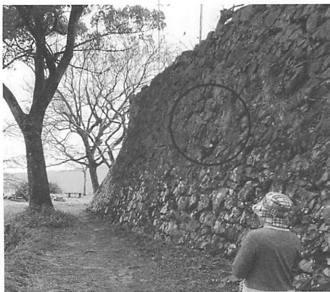
石垣の孕みの部分＝石垣崩壊推定区域 提供編集部
